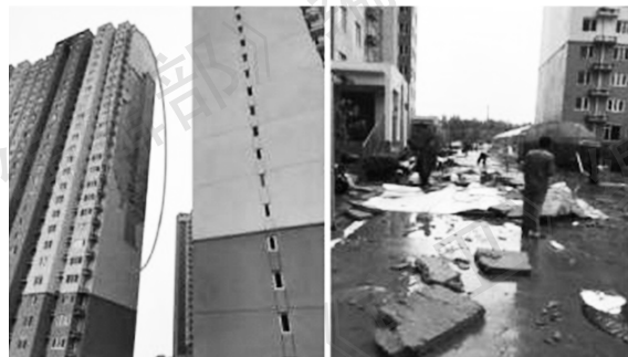
图2 外墙渗漏水导致墙体脱落
