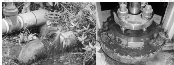
图1 质量问题导致的压力管道阀门泄漏与松动
