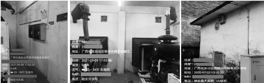
图 5 融安综合接入局站自动通风系统组图
