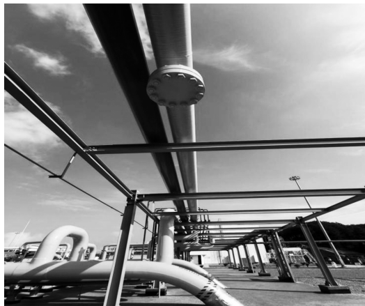
图3 天然气增压站
